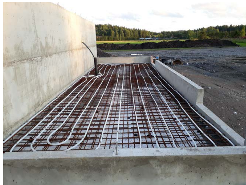
Kuva: Takaniityn tallin pihaton lämmöntalteenottoputkisto
